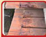
錆による腐食
