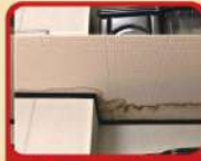
雨漏りによる天井のシミ
